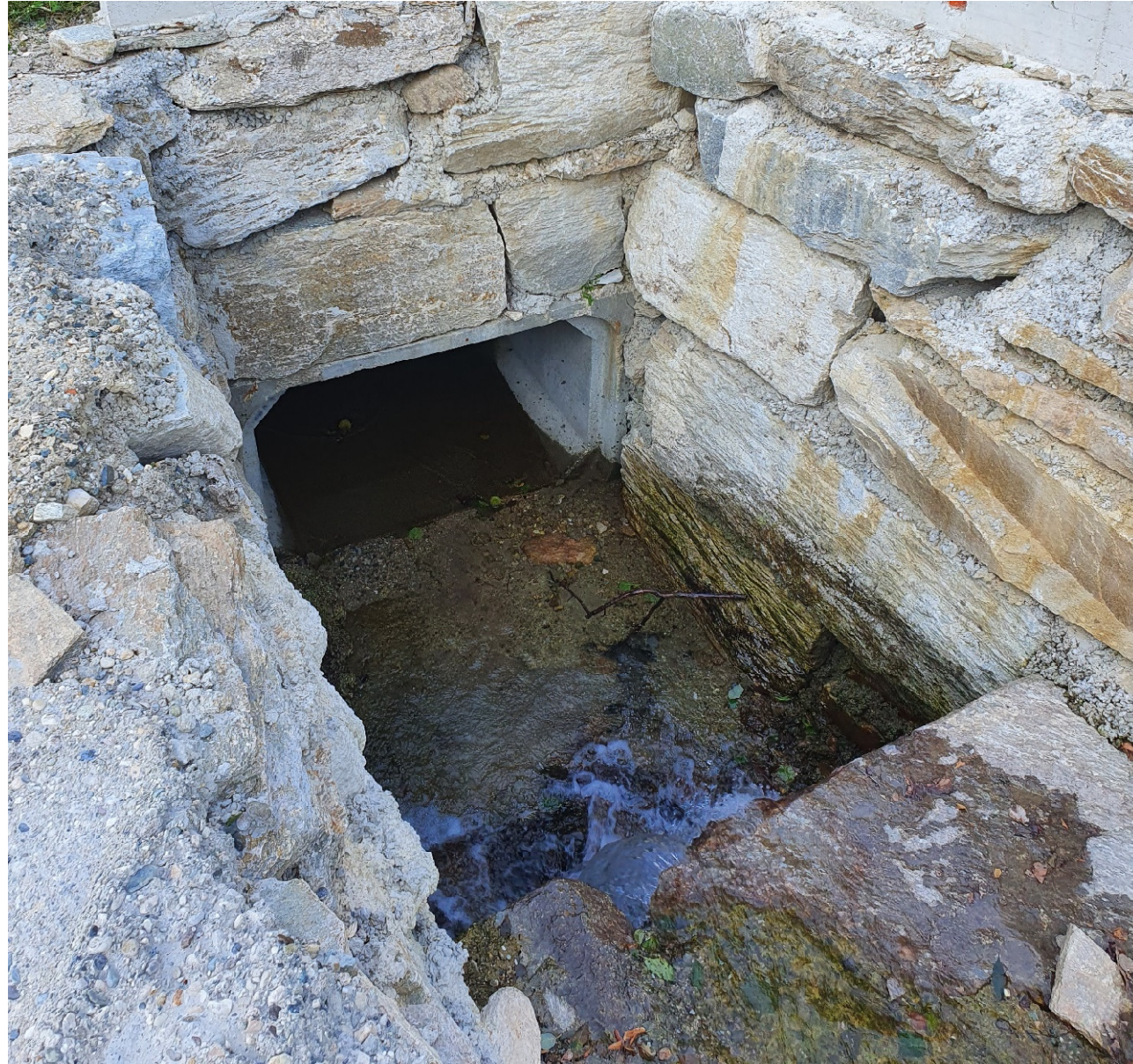
Vista da monte verso valle dell'attraversamento del Rio Comba La Losa - PEGFPO013
