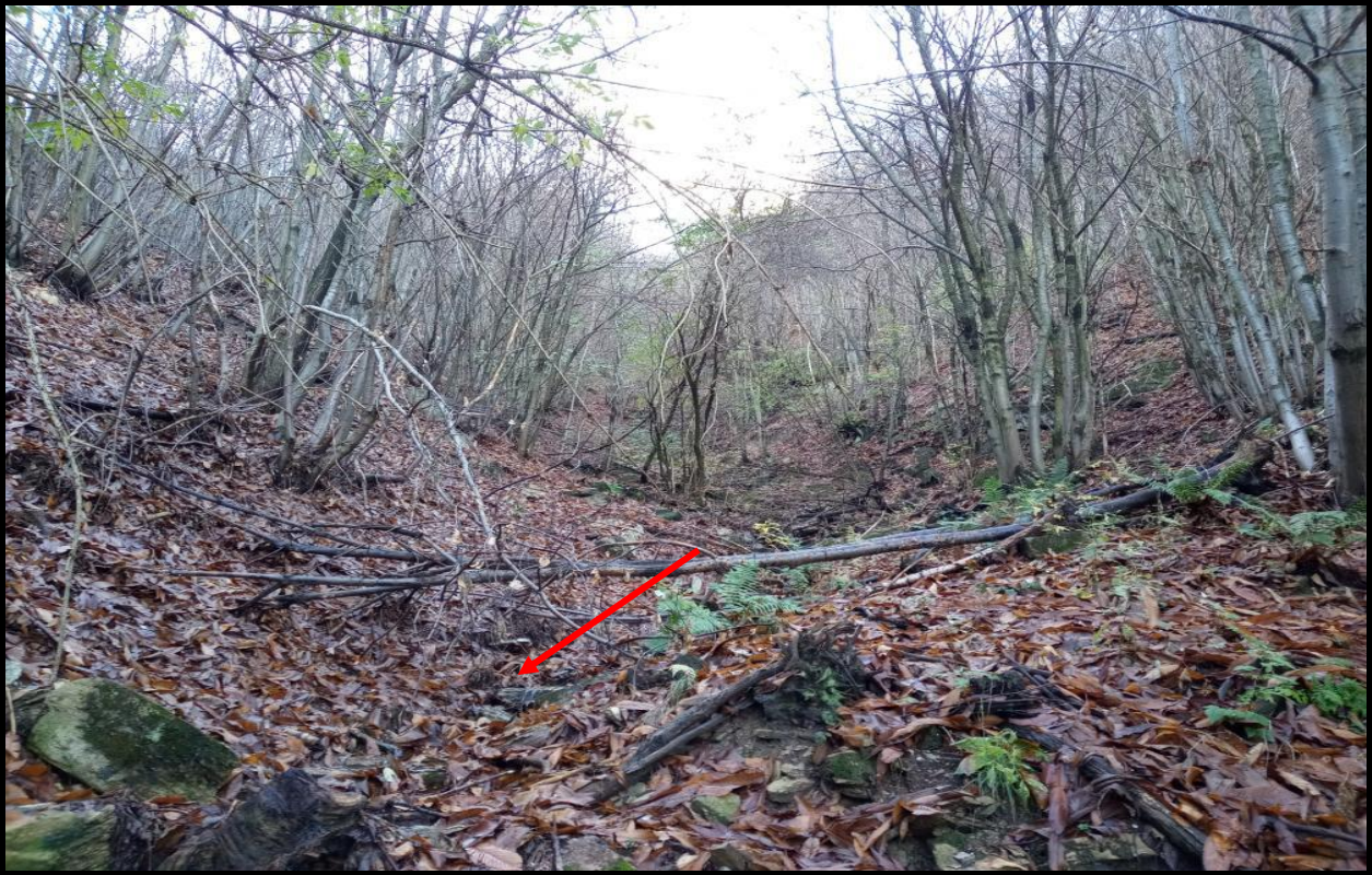
FOTO 2 - Zona di frana 1 - FQ6 verso monte.
