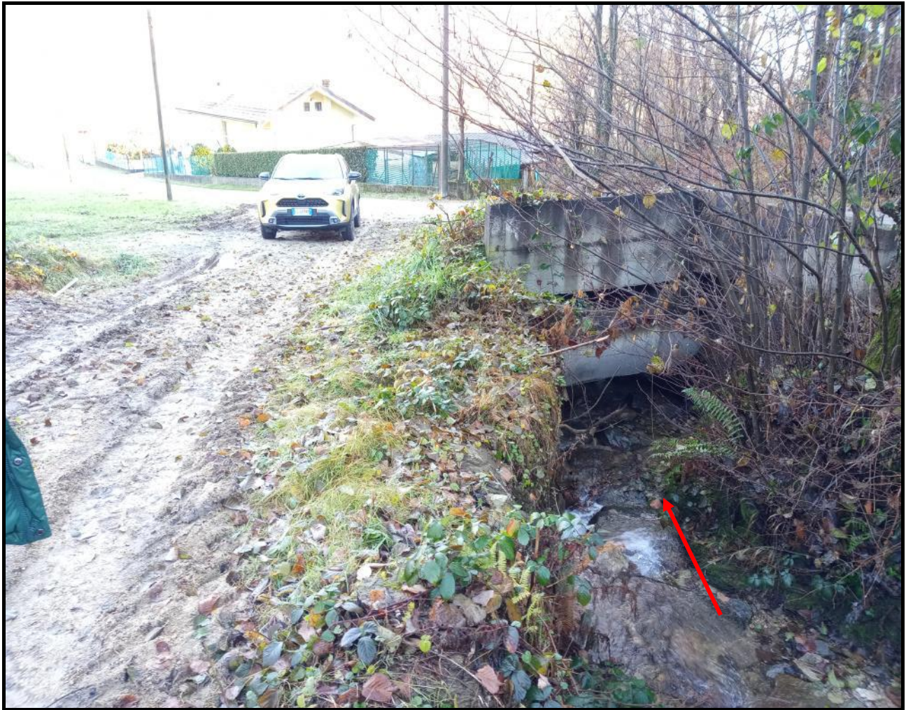
FOTO 6 – Alveo del rio Comba La Losa nella zona d'intersezione con il canale artificiale Becetto. Si nota la riduzione della sezione di deflusso del rio ad opera dell'attraversamento del canale Becetto.
