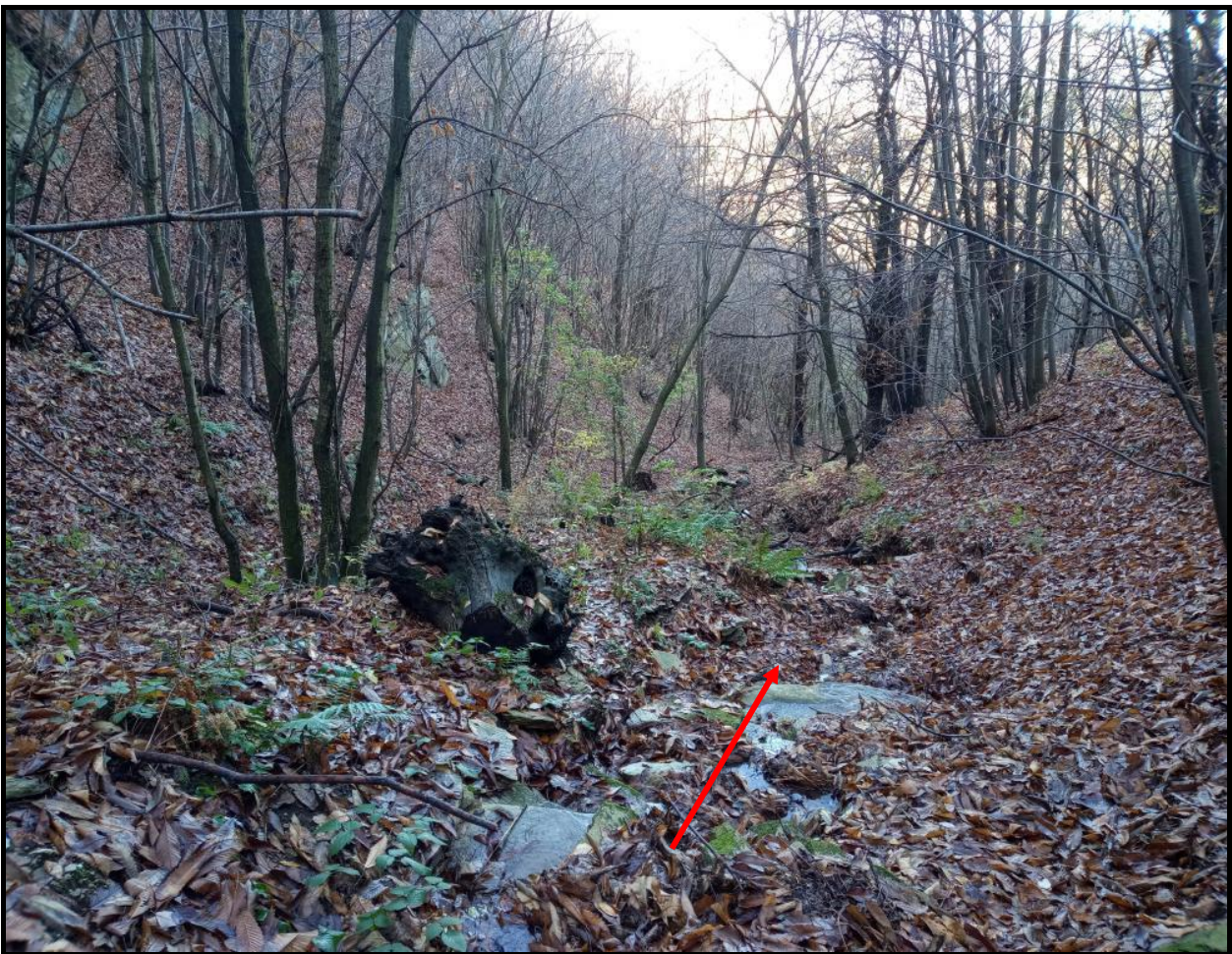
FOTO 3 – Zona di frana 1 – FQ6 verso valle.
